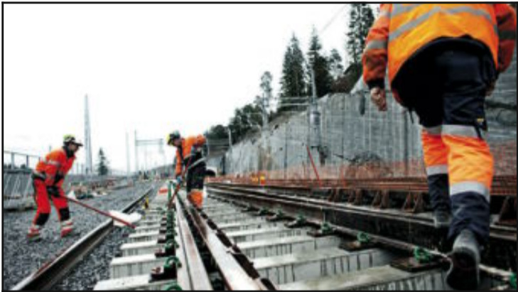
BYGGER UT: Jernbaneverket bruker 1,4 milliarder på rådgivere til nye prosjekter. Her fra byggingen av Lysaker-Sandvika i år.
